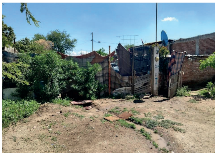
Imagen 1. Vivienda con canal de aguas negras improvisado en vivienda
